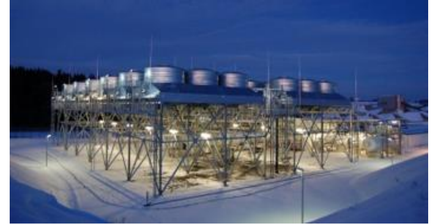
Holzkirchen geothermie installatie
